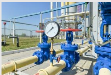
Stazioni di compressione gas
