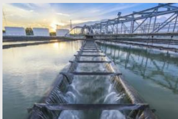
Impianti di trattamento delle acque reflue
